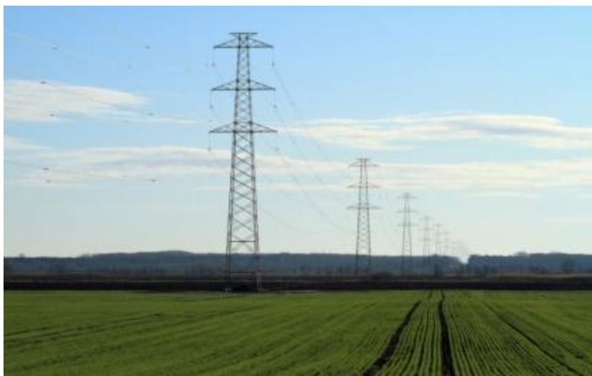
Figura 43: Linia electrică aeriană de 400 kV între Martonvásár și Győr, cu stâlpi în formă de brad
